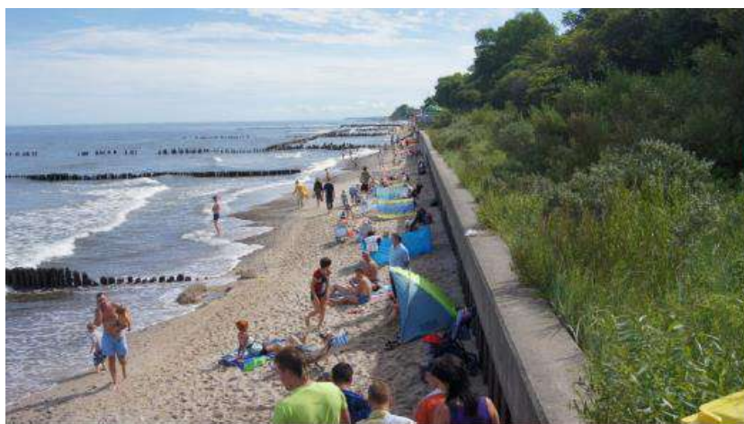
Fot. 1 Wąska plaża i betonowy mur oporowy w Kołobrzegu przed wykonaniem projektu, źródło; materiały d. UM Słupsk
