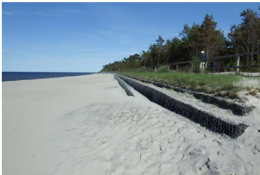
Fot. 1 Gabiony częściowo pokryte piaskiem w oczekiwaniu na sztuczne zasilanie, Jastrzębia Góra – Ostrowo, 2015 (fot. G. Różyński)
